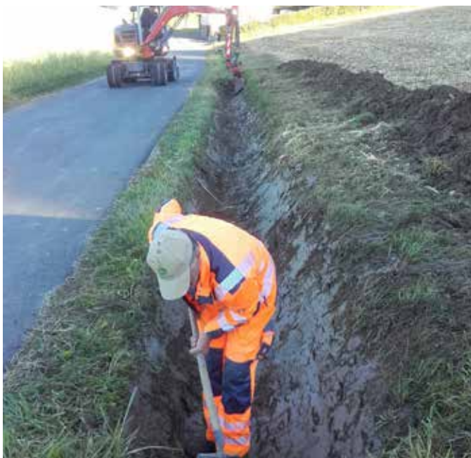
Von angrenzenden Äcker verschlammte Gräben, welche immer wieder mühselig geputzt werden müssen!
